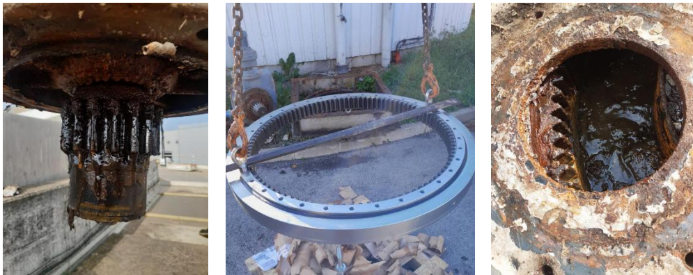
Poste de relevage Biofiltre
